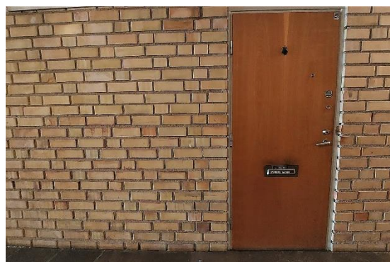
Lägenhetsdörr infälld i tegelväggen utan foder.
