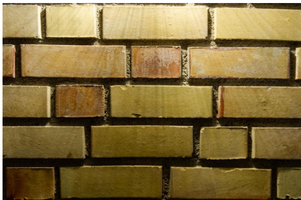
Tegel i korridorer med djupa fogar.
